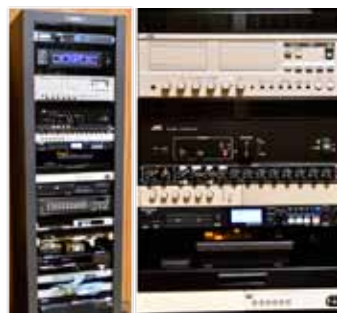
▲PM-5000シリーズ、音響設備の機器架
