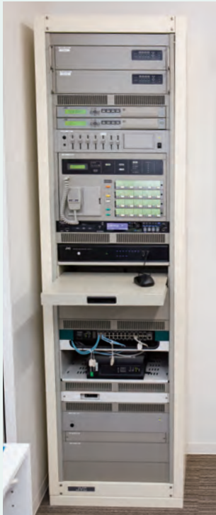
業務用放送設備EM-D300シリーズと音響機器、防犯カメラのレコーダーをラックに収納
