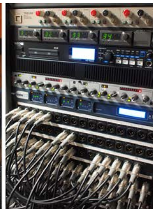
新たに設置された 電気音響設備
