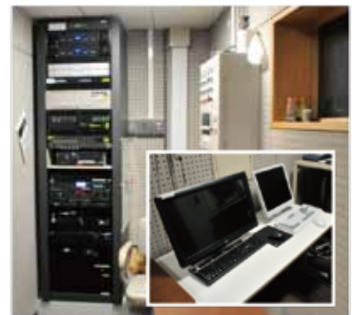
バックヤード（ラックシステム）
