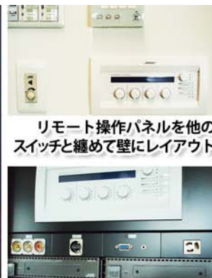
リモート操作パネルを他のスイッチと纏めて壁にレイアウト JKPI オーダーメイドAVパネルで拡張性を向上
