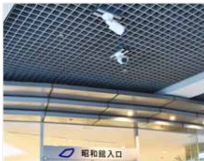
▲入り口/駐車場には赤外LED照明器搭載カメラ
